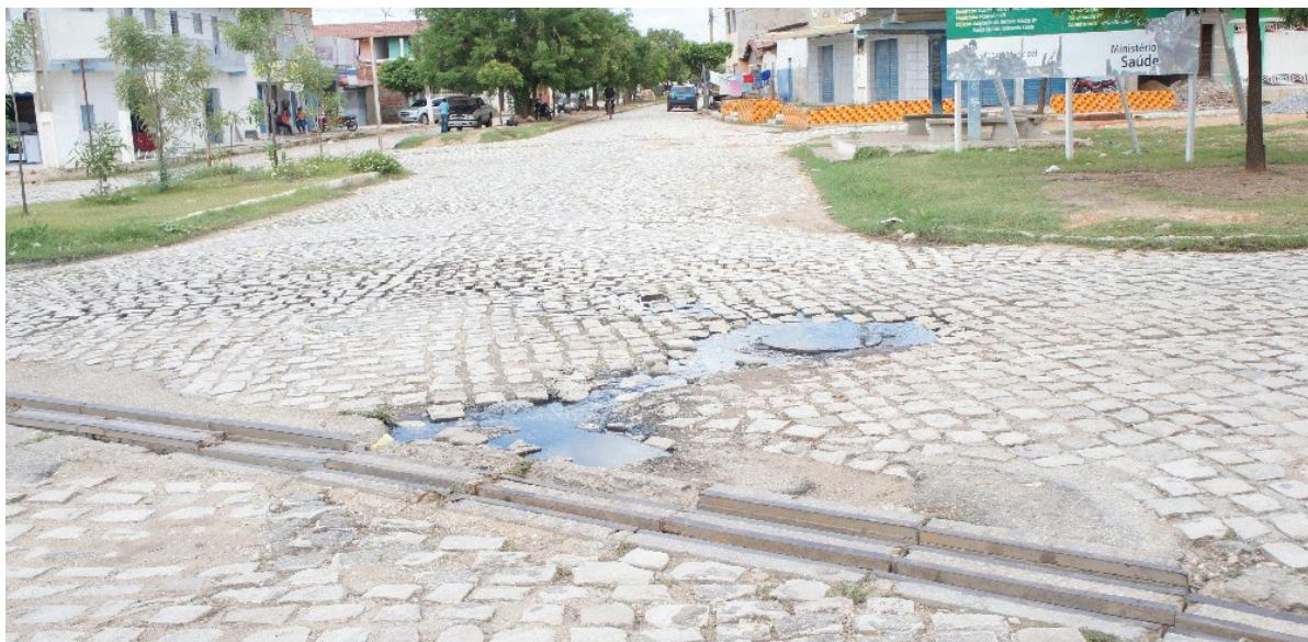
Caern alerta: fazer a ligação do sistema de esgotamento sem que ele esteja concluído gera transbordamento de água servida nas ruas
